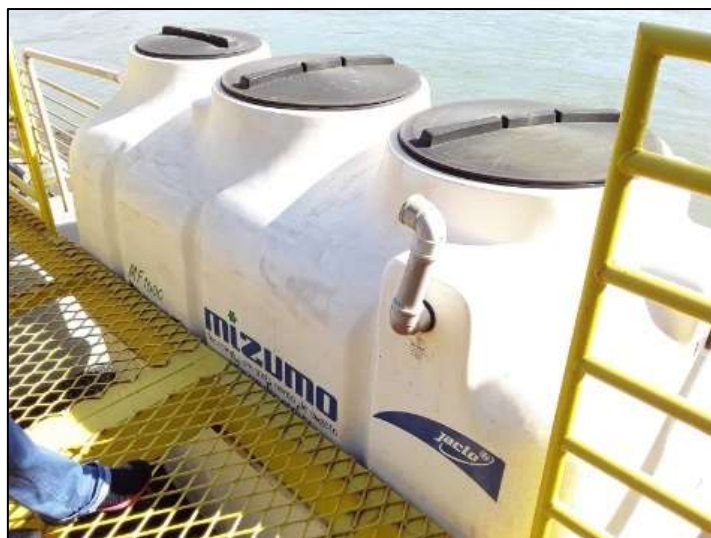
Figura 6.7 - Sistema de tratamento Mizumo Family utilizado para tratamento dos efluentes domésticos gerados no edifício de controle.
