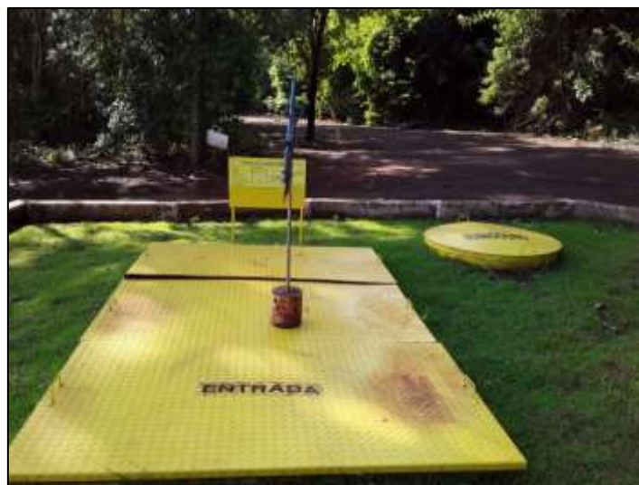
Figura 6.6 - Sistema de tratamento composto por tanque séptico seguido de sumidouro, utilizado para tratamento dos efluentes domésticos gerados no prédio do consórcio.
